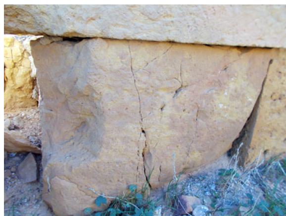
Figure 19. fissure due à une action mécanique.
